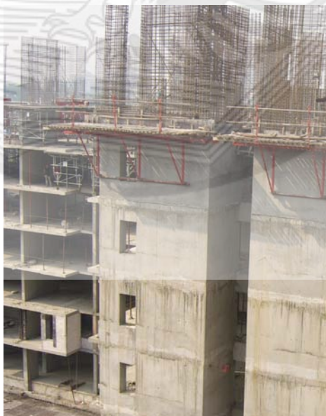
Gambar 1.1 Bukaan pada Shear Wall Sumber: Proyek Apartemen Mediterania Garden Residence 2, 2006
