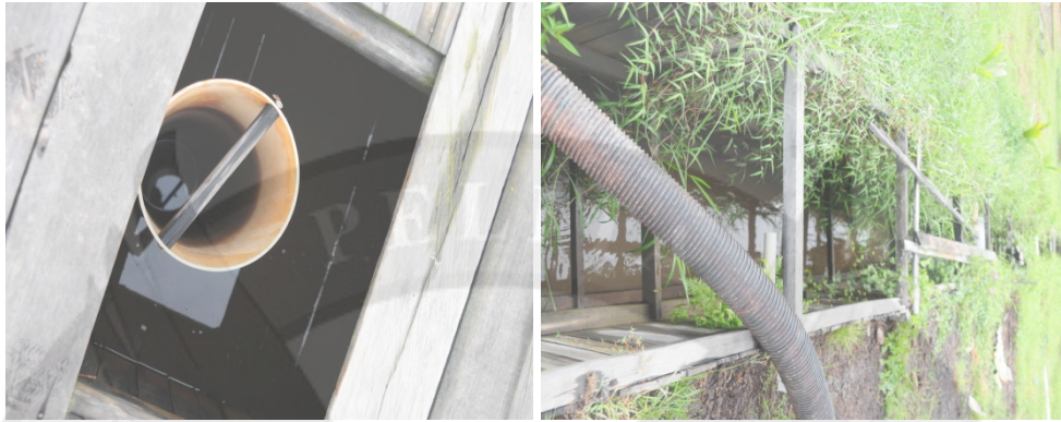
(a) Pipa tegak pembuangan air kolam
