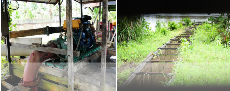
(a) Salah satu pompa pemasukan air (b) Parit pemasukan dari sei.Ambawang
