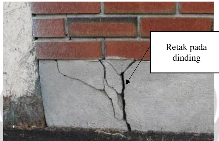
Gambar 1. 2 Kerusakan dinding Sumber: King, 2005
