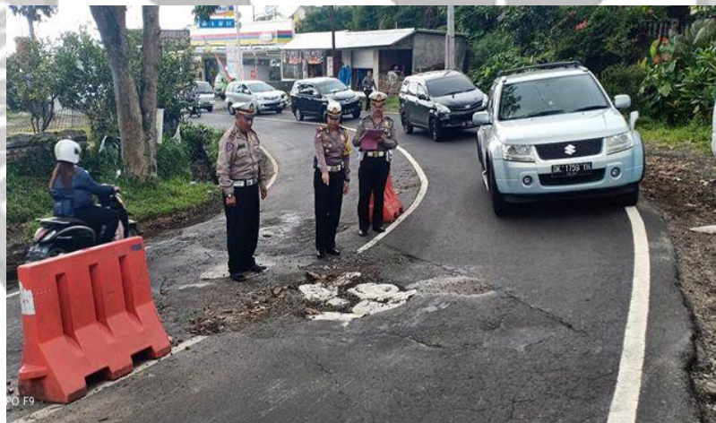
Gambar 1.1 Salah Satu Contoh Perkerasan Jalan yang Mengalami Stripping Akibat Moisture Damage
