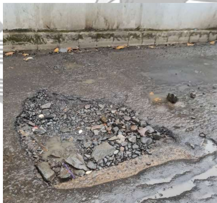
Gambar 1.1 Kerusakan Jalan di Daerah Harapan Kita, Karawaci
