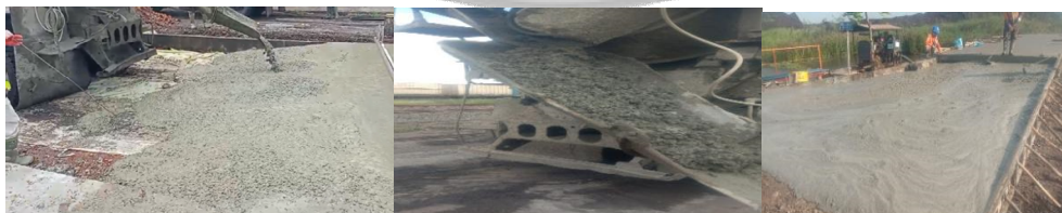
Gambar 1.2 Gambar waste defect pada beton ready mix (Sumber : Data Perusahaan PT. XYZ)
